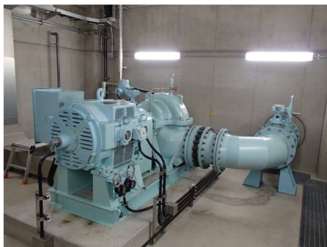
小水力発電設備
